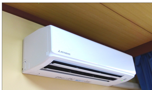
全居室エアコン
